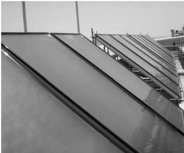
Figure 17 – Capteurs solaires sur support en toit plat, inclinés à 45°
